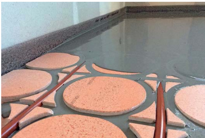
Am Schluss wird der Boden mit der zementären Vergussmasse vergossen. Sie bildet die Grundlage für den späteren Bodenbelag.
