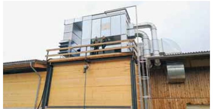
Das Planungsteam steht in luftiger Höhe vor der vollständig installierten MultiStar C Filteranlage. Jürg Rutishauser (l.), André Kretz (r.).
