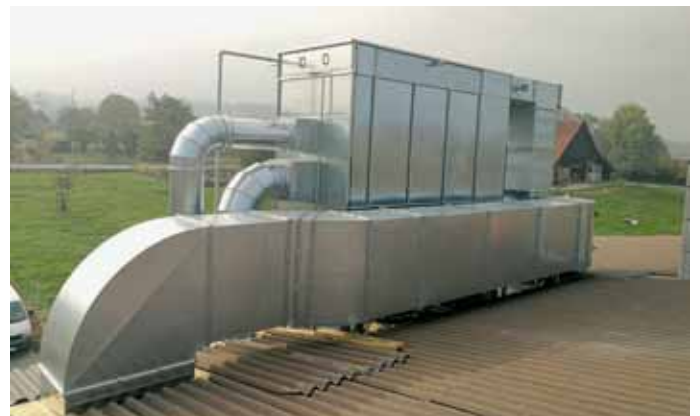
Die gefilterte Luft wird in die Halle zurückgeführt, und die Wärmeenergie bleibt erhalten.
