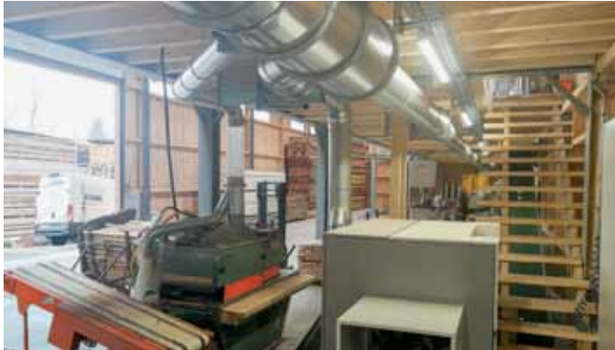
Automatisierte Schiebersteuerungen an sämtlichen Maschinen.
