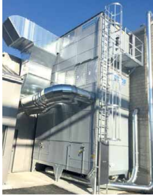
Die Reinluftfilteranlage Profi Jet mit Rückluftkanal und Transportleitung.
